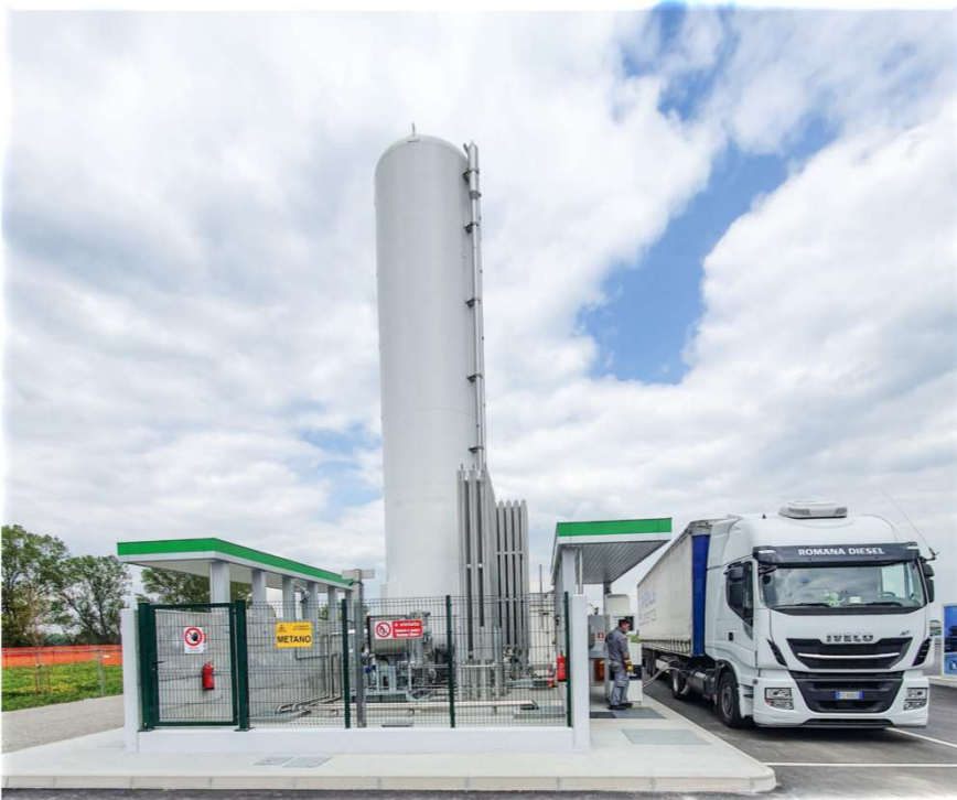
LNG fueling plant – Fidenza - Italy
