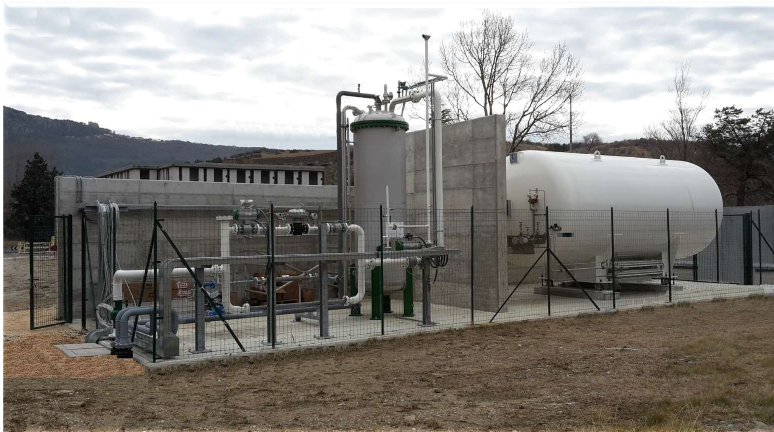
Usine de stockage et de vaporisation d'éthane – Trieste - Italy
