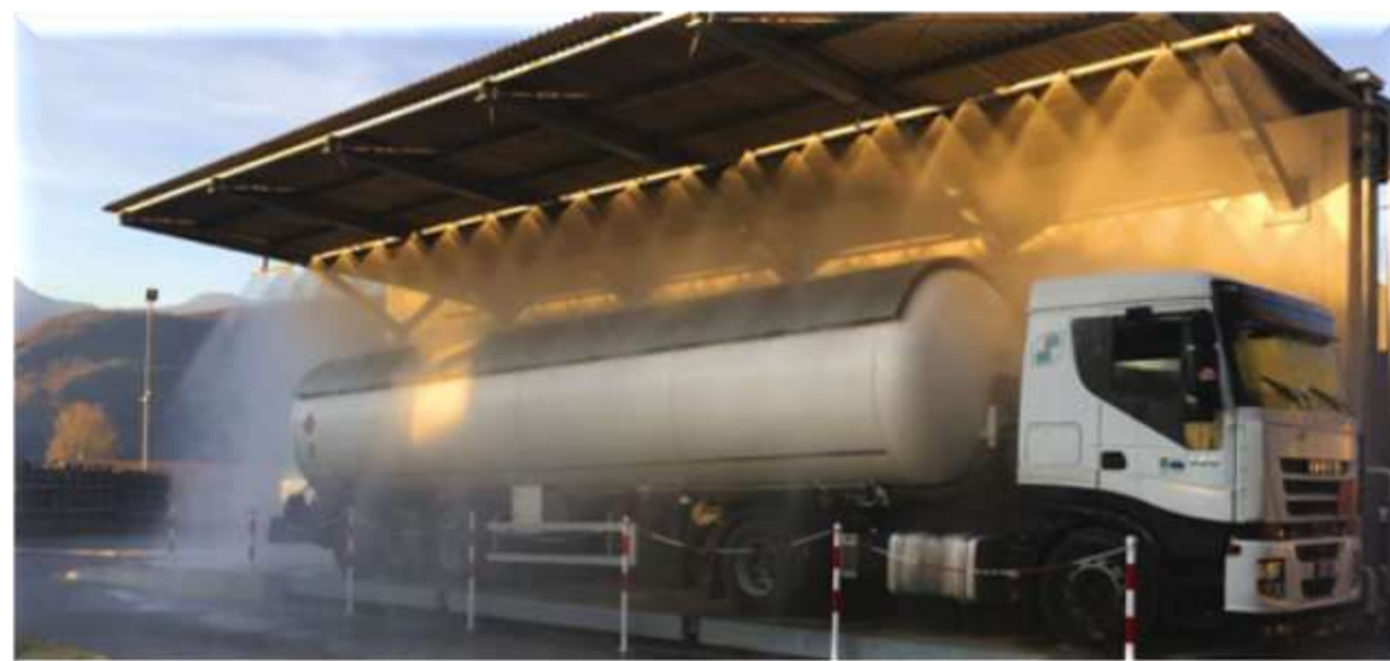
Essai d'un système de gicleurs sur une baie de chargement/déchargement
