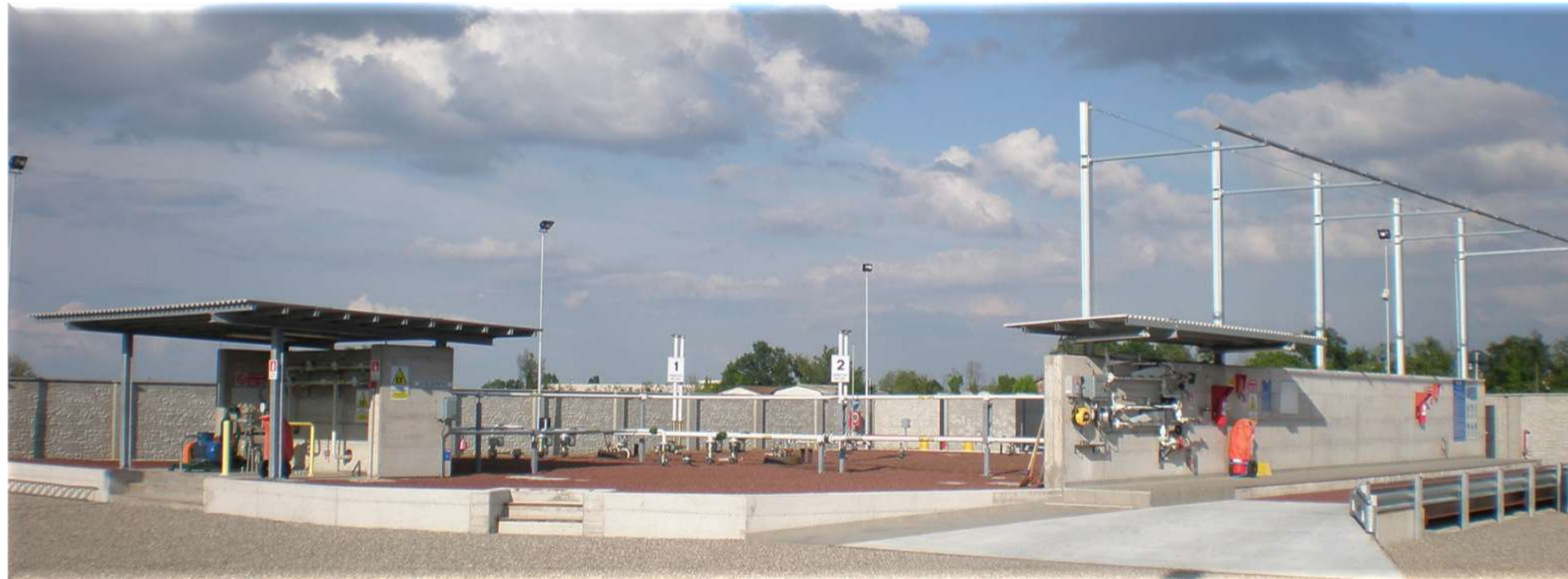
Stockage secondaire du GPL – point de dechargement et salle des pompes
