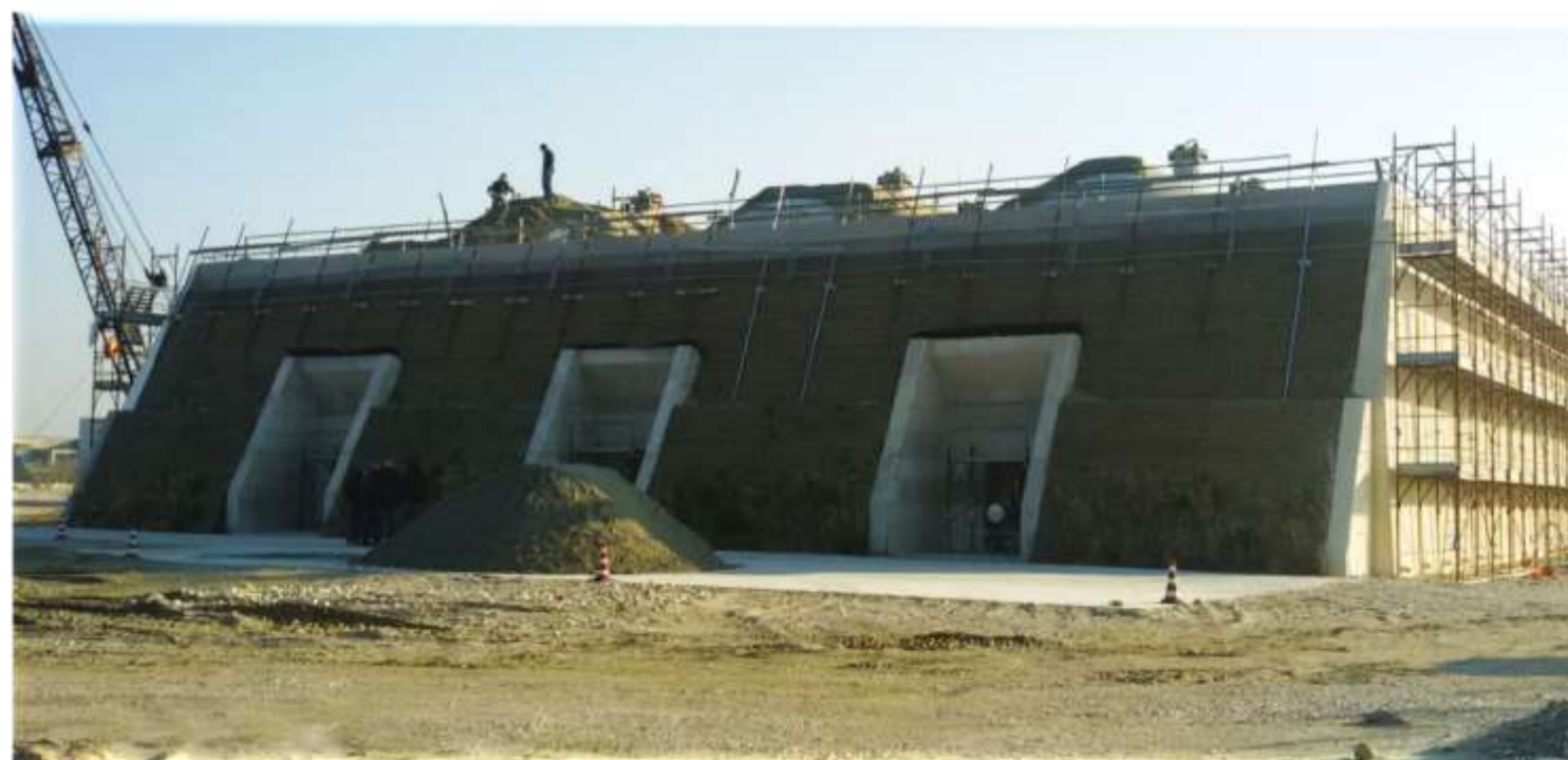
Stockage primaire de GPL – réservoirs enterrés horizontaux – Venice - Italy
